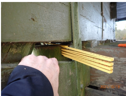
Bild 5 - Påle saknar anliggning
