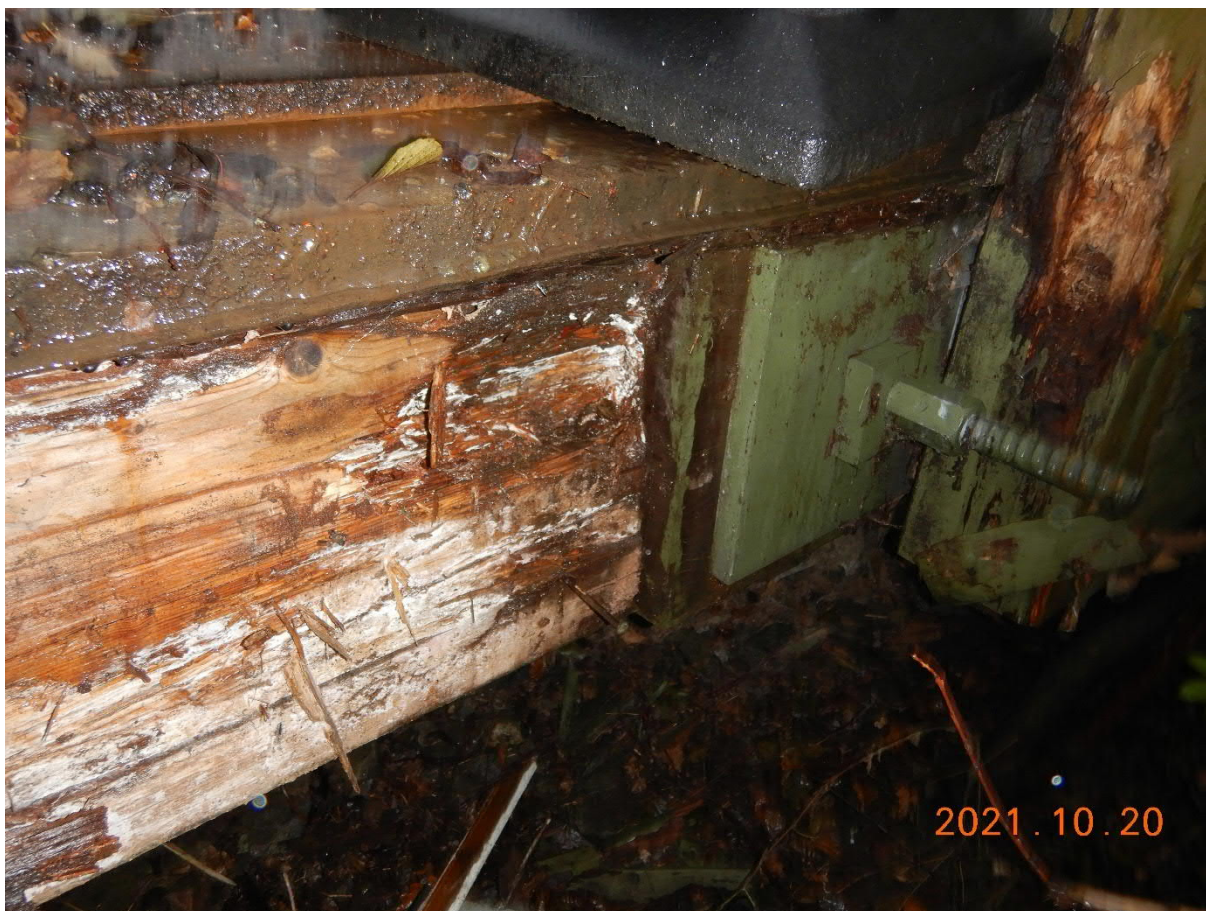
Foto nr 14, röta i plattsidor där spännstag sjunkit in i yttre lammeller
