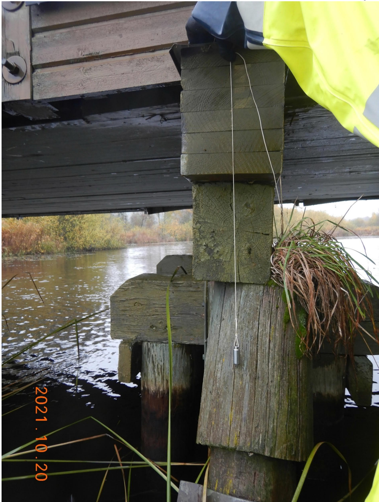
Foto nr 34, rörelse skivpelare stöd G
