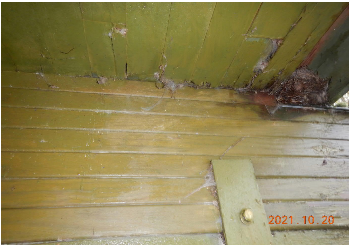
Foto nr 18, röta i plattsidor över stöd
