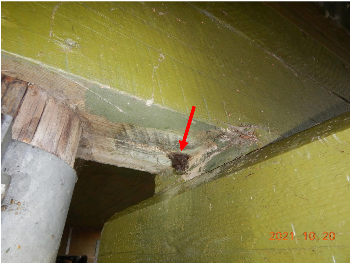
Foto nr 40, korrosion på stag genom skivdel av mellanstöd
