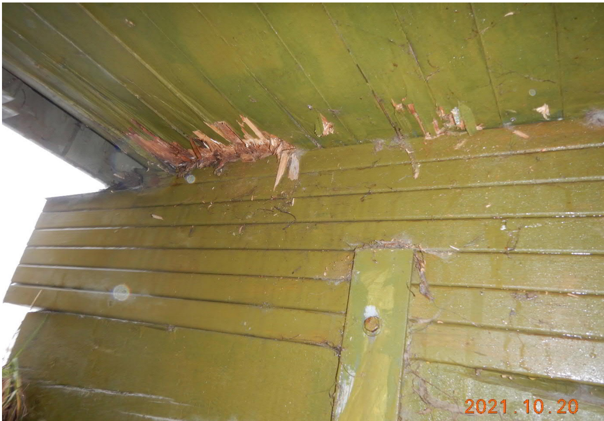
Foto nr 17, röta i plattsidor över stöd
