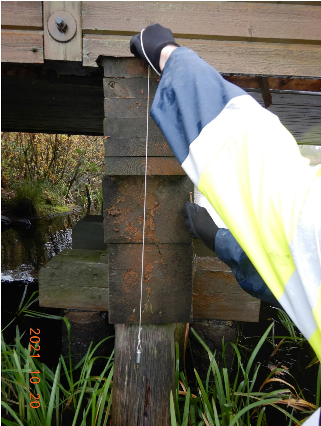
Foto nr 33, rörelse skivpelare stöd C
