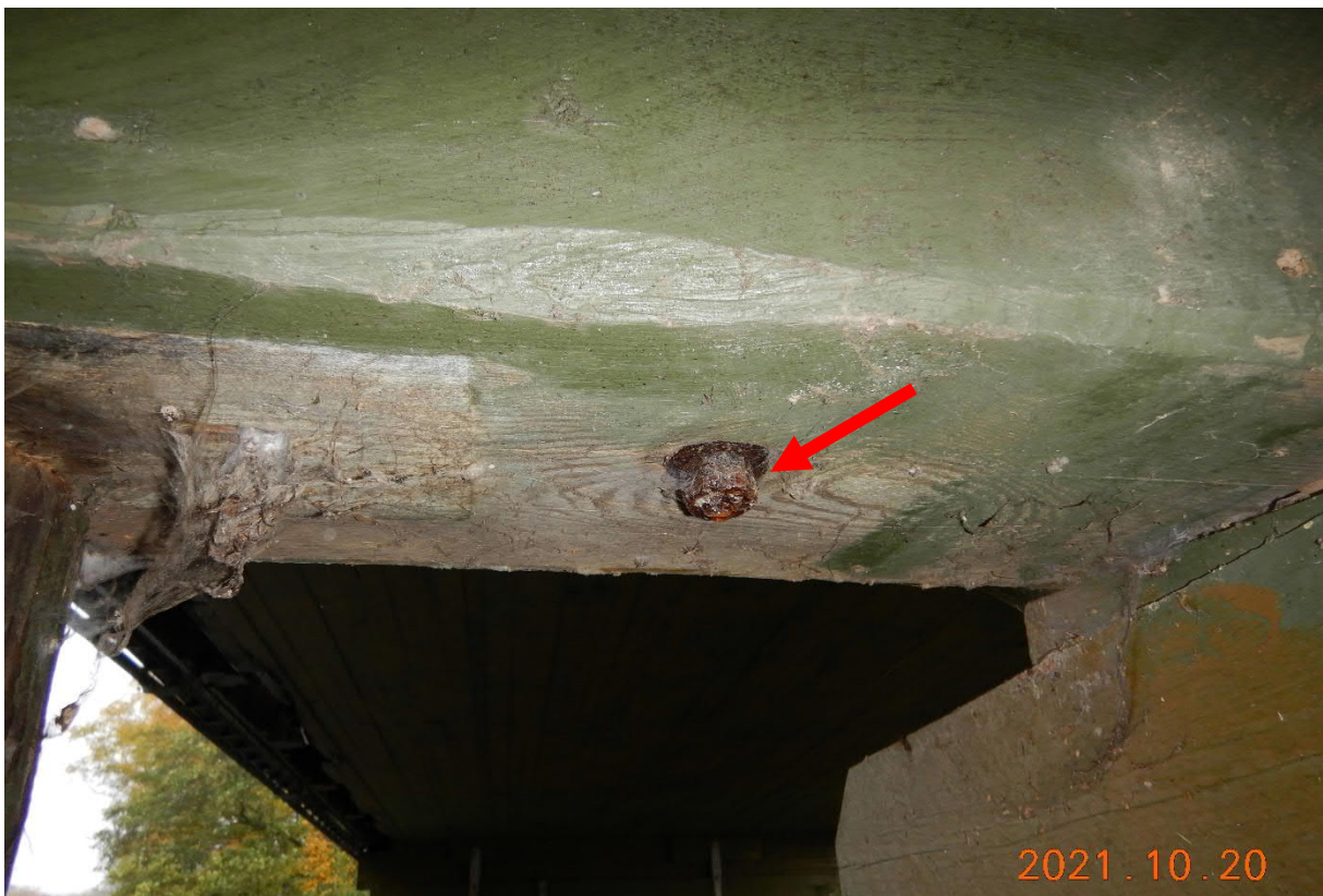
Foto nr 39, korrosion på stag genom skivdel av mellanstöd
