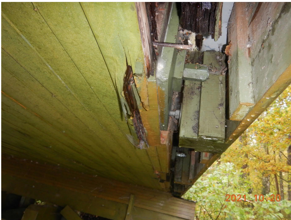
Foto nr 15, röta i plattsidor där spännstag sjunkit in i yttre lammeller
