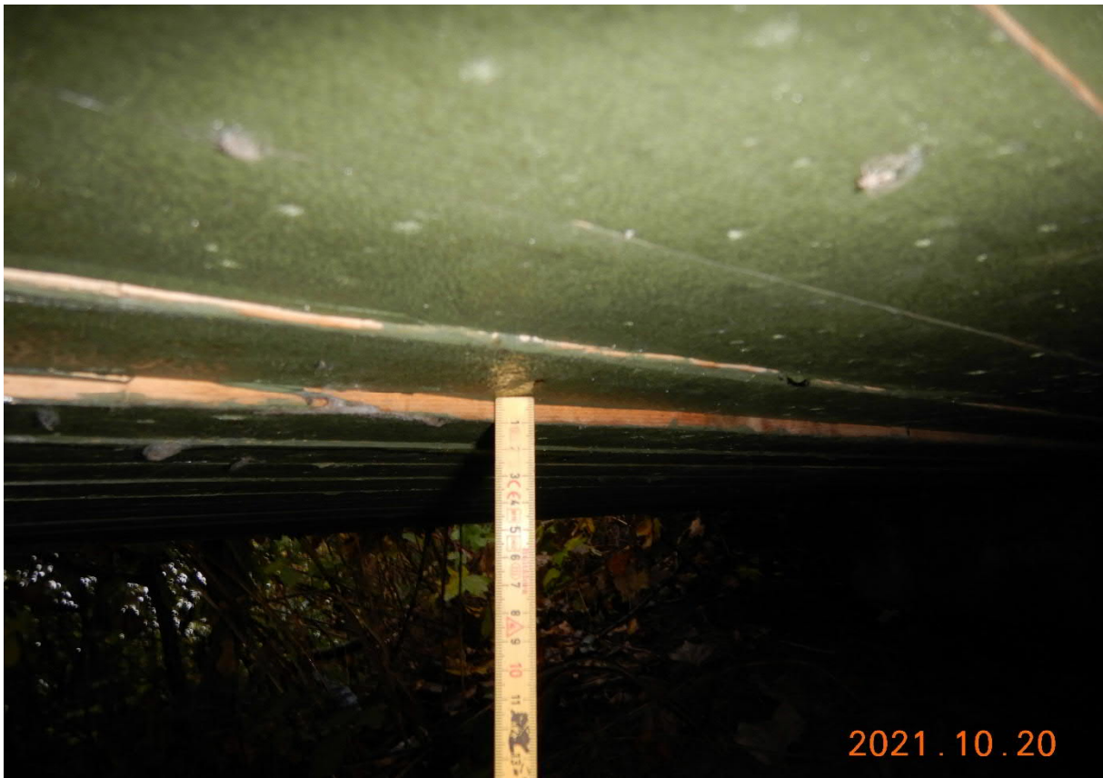
Foto nr 19, rörelser i broplattan pga förlorad spännkraft i spännstag
