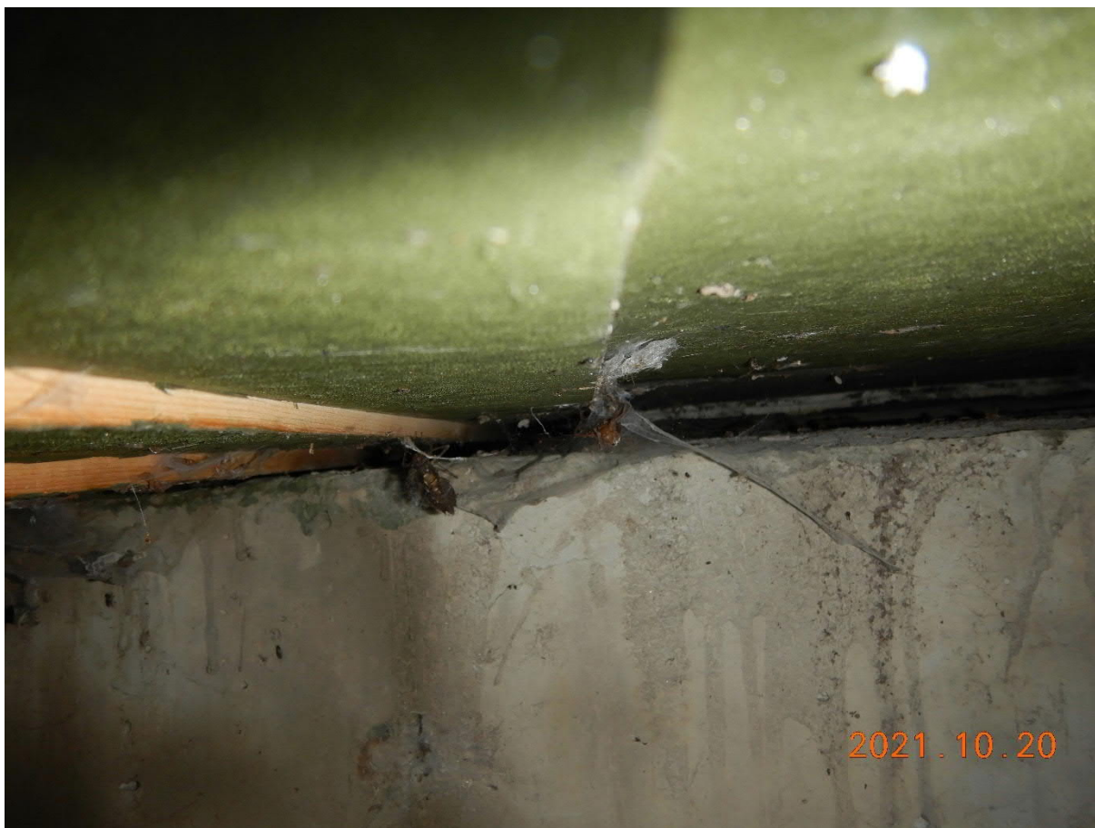
Foto nr 21, rörelser i broplattan pga förlorad spännkraft i spännstag
