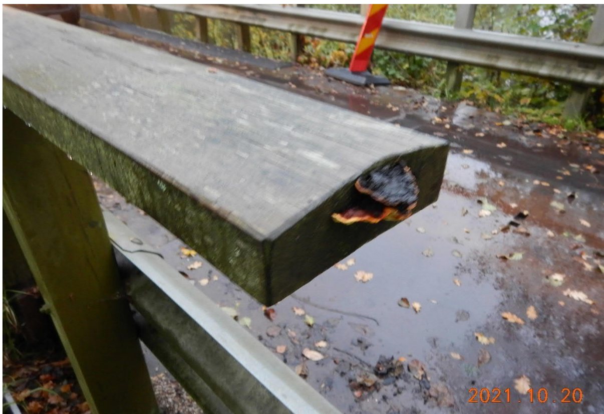
Foto nr 13, röta och svamppåväxt i räcketts toppföljare
