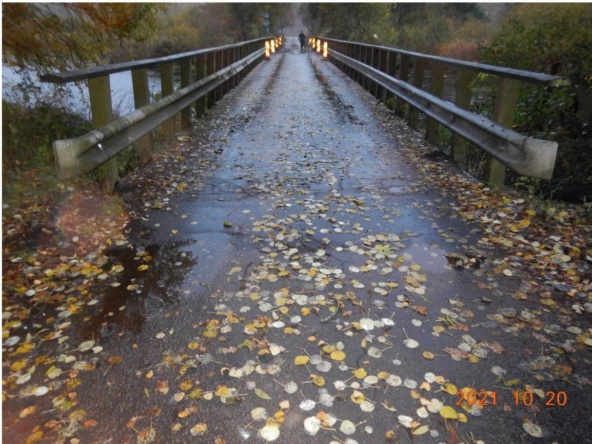
Foto nr 35, slaghål innan bron och körspår över bron
