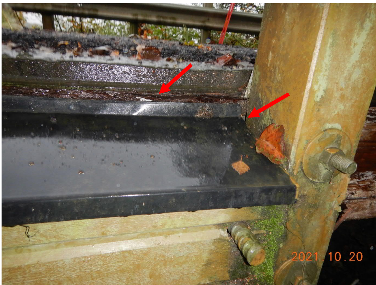
Foto nr 36, Otät täckplåt på plattsidor
