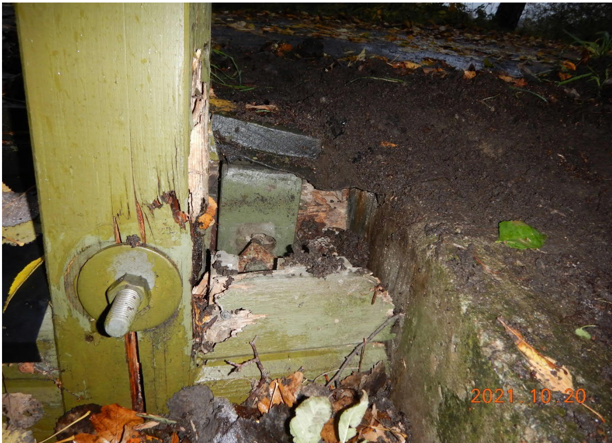
Foto nr 5, rötskador räcketståndare
