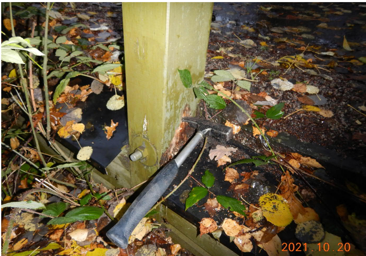
Foto nr 6, rötskador räcketståndare
