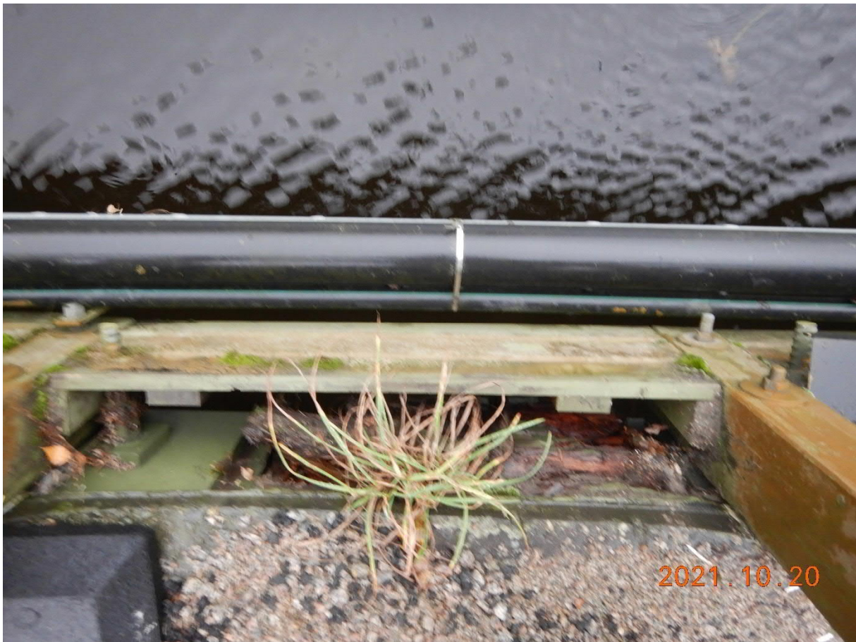
Foto nr 38, Saknad täckplåt på plattsidor
