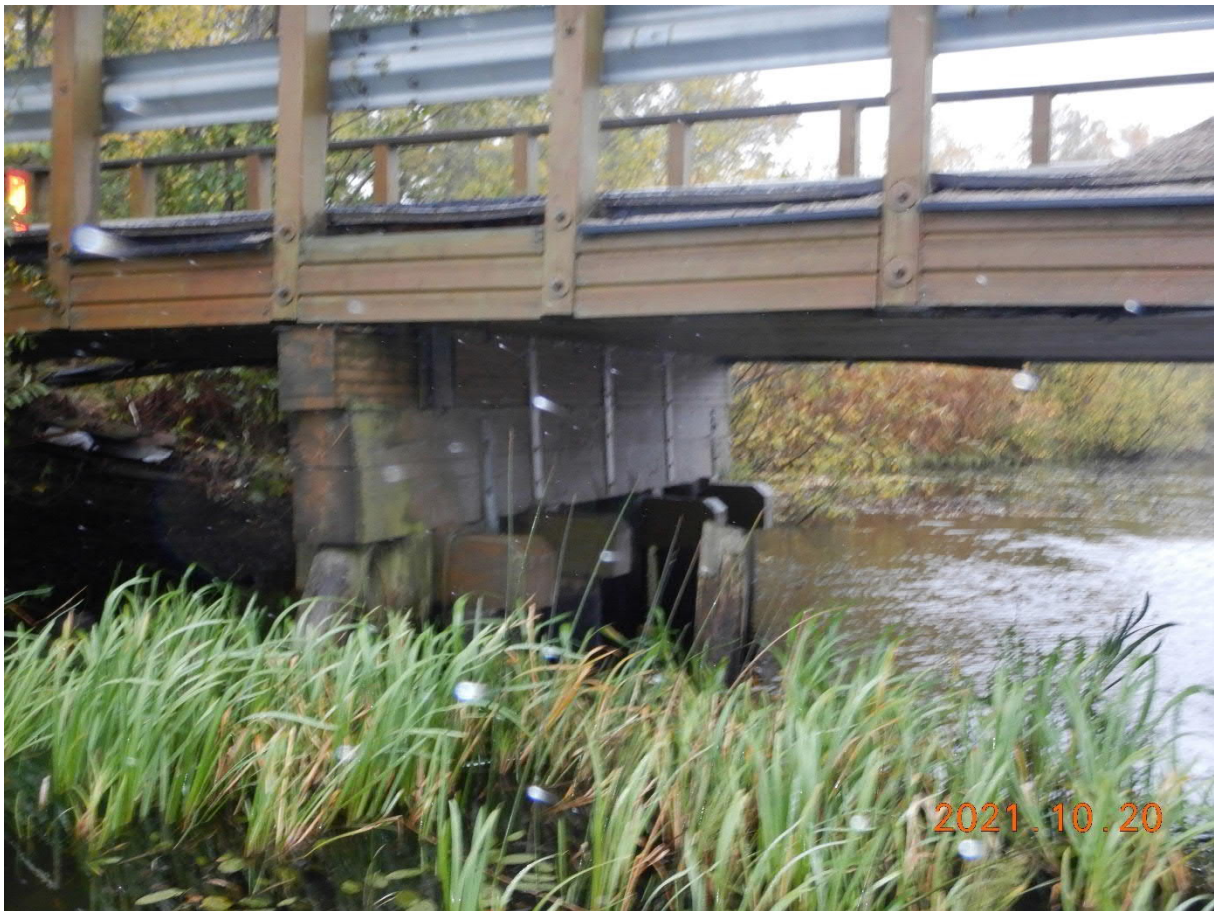
Foto nr 32, rörelse skivpelare stöd C
