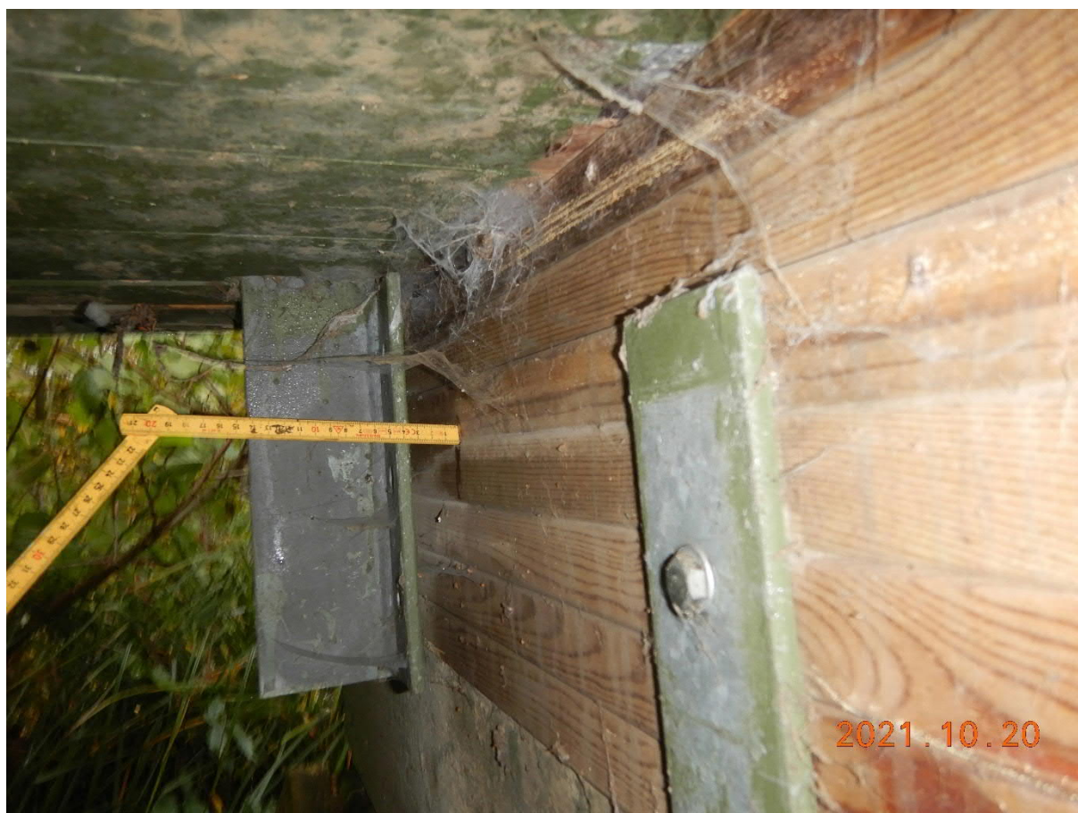
Foto nr 24, infästningsdetalj lös och saknar infästningar vid mellanstöd
