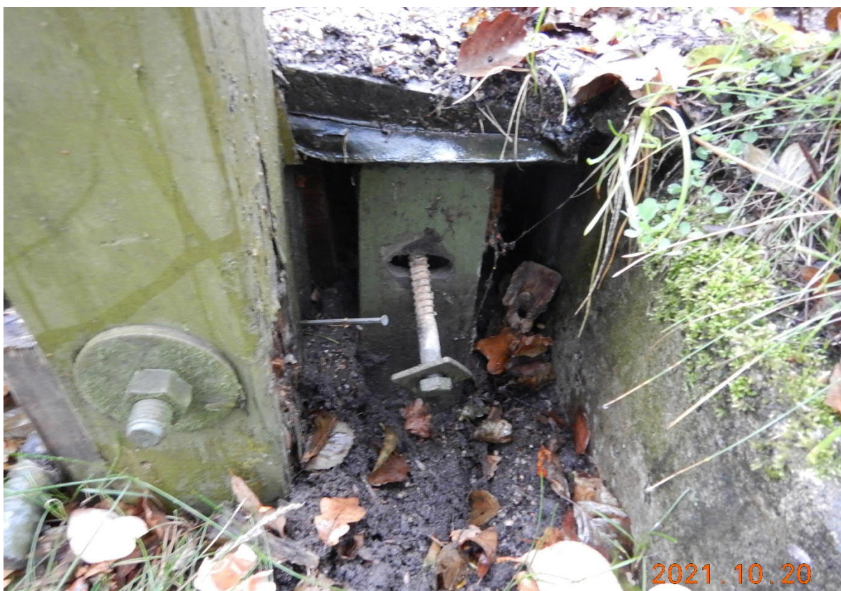
Foto nr 22, infästningsdetalj lös pga röta i platta vid landfäste
