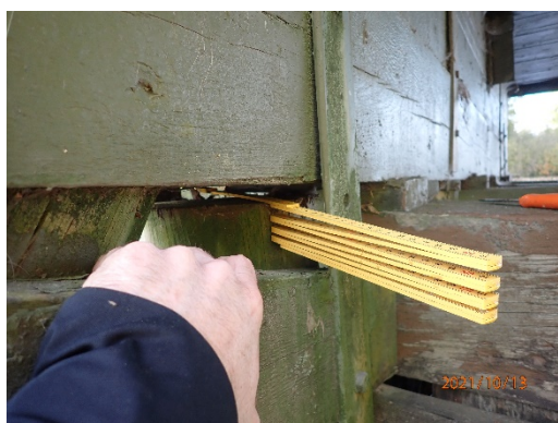
Bild 5 - Påle saknar anliggning
