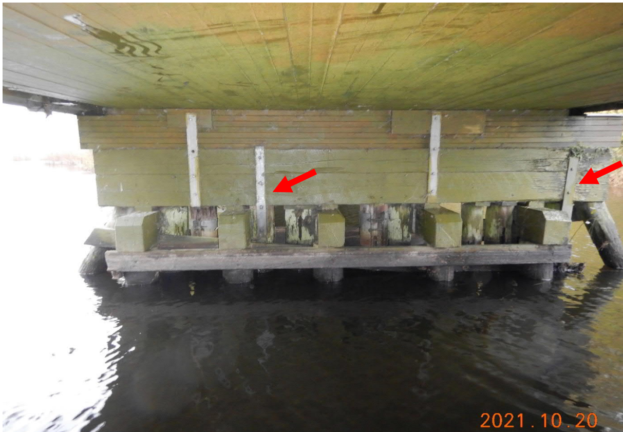
Foto nr 28, infästningsdetalj för överföring laster i gammal pålning
