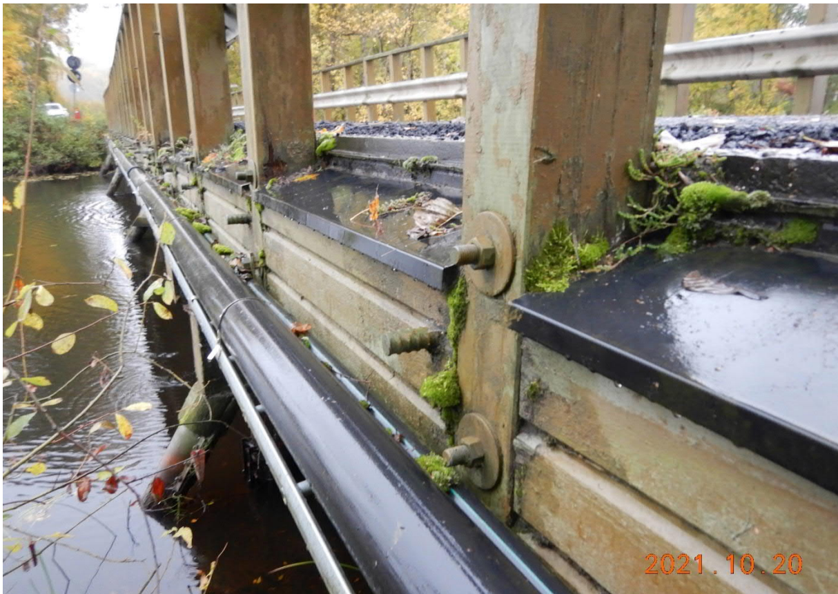
Foto nr 7, rötskador räcketståndare och påväxt av mossa
