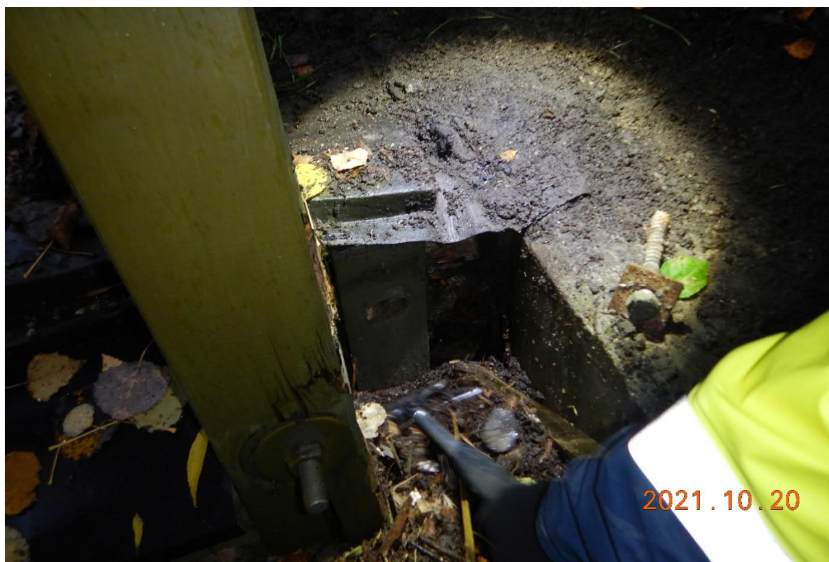
Foto nr 23, infästningsdetalj lös pga röta i platta vid landfäste
