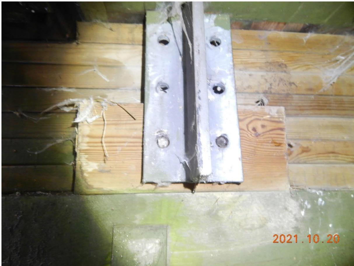
Foto nr 27, infästningsdetalj lös och saknar infästningar vid mellanstöd
