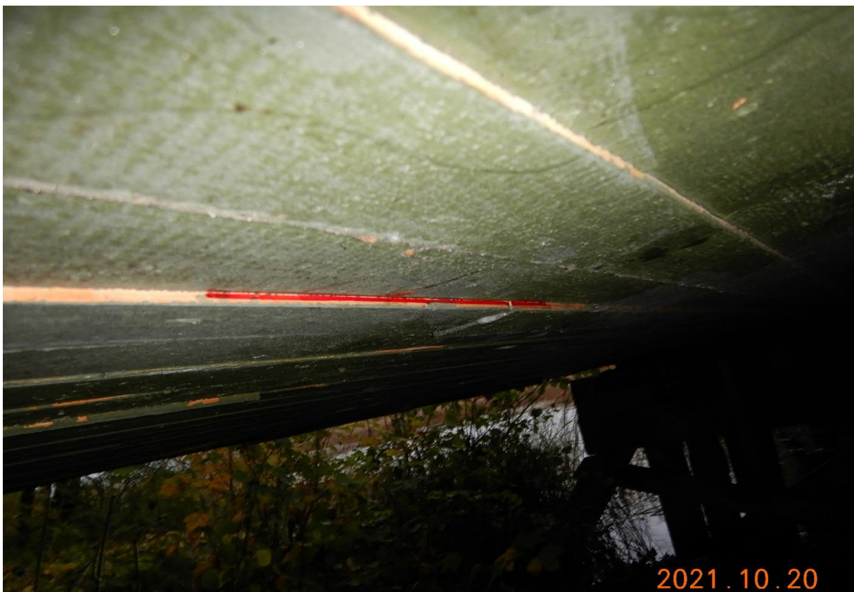
Foto nr 20, rörelser i broplattan pga förlorad spännkraft i spännstag
