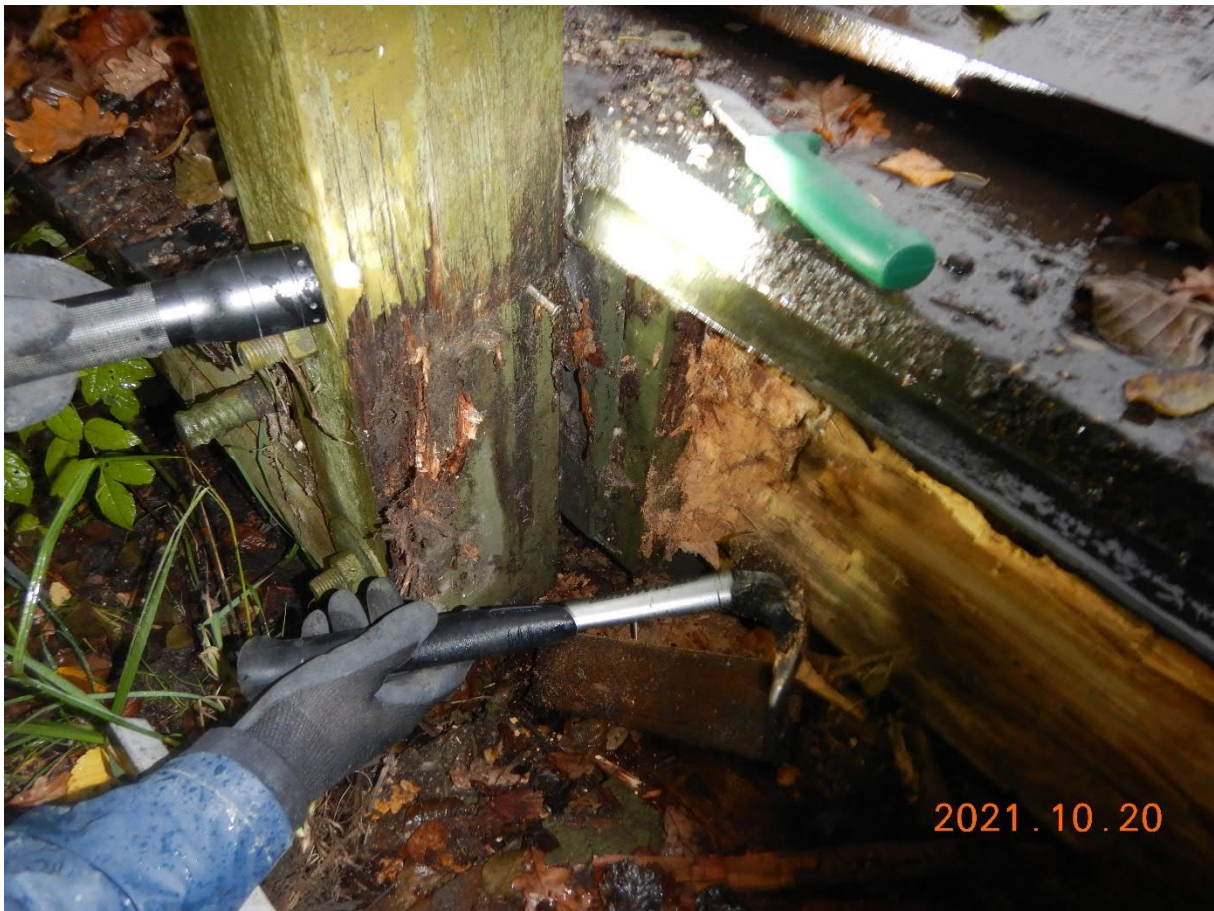
Foto nr 3, rötskador räcketståndare och plattsida
