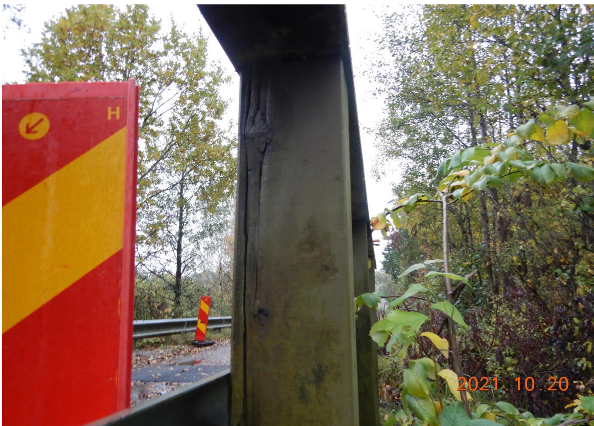
Foto nr 8, rötskador räcketståndare
