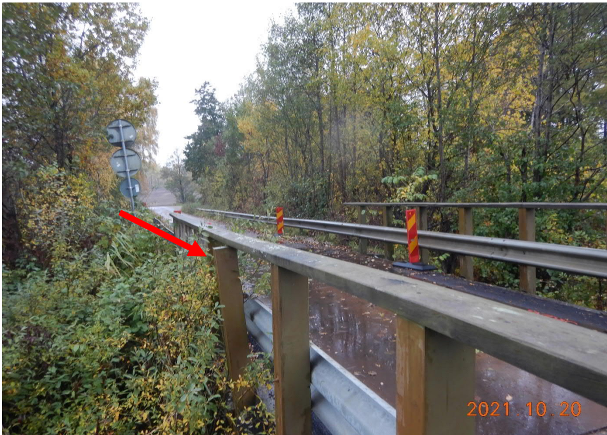
Foto nr 9, rötskador och lös räcesständer
