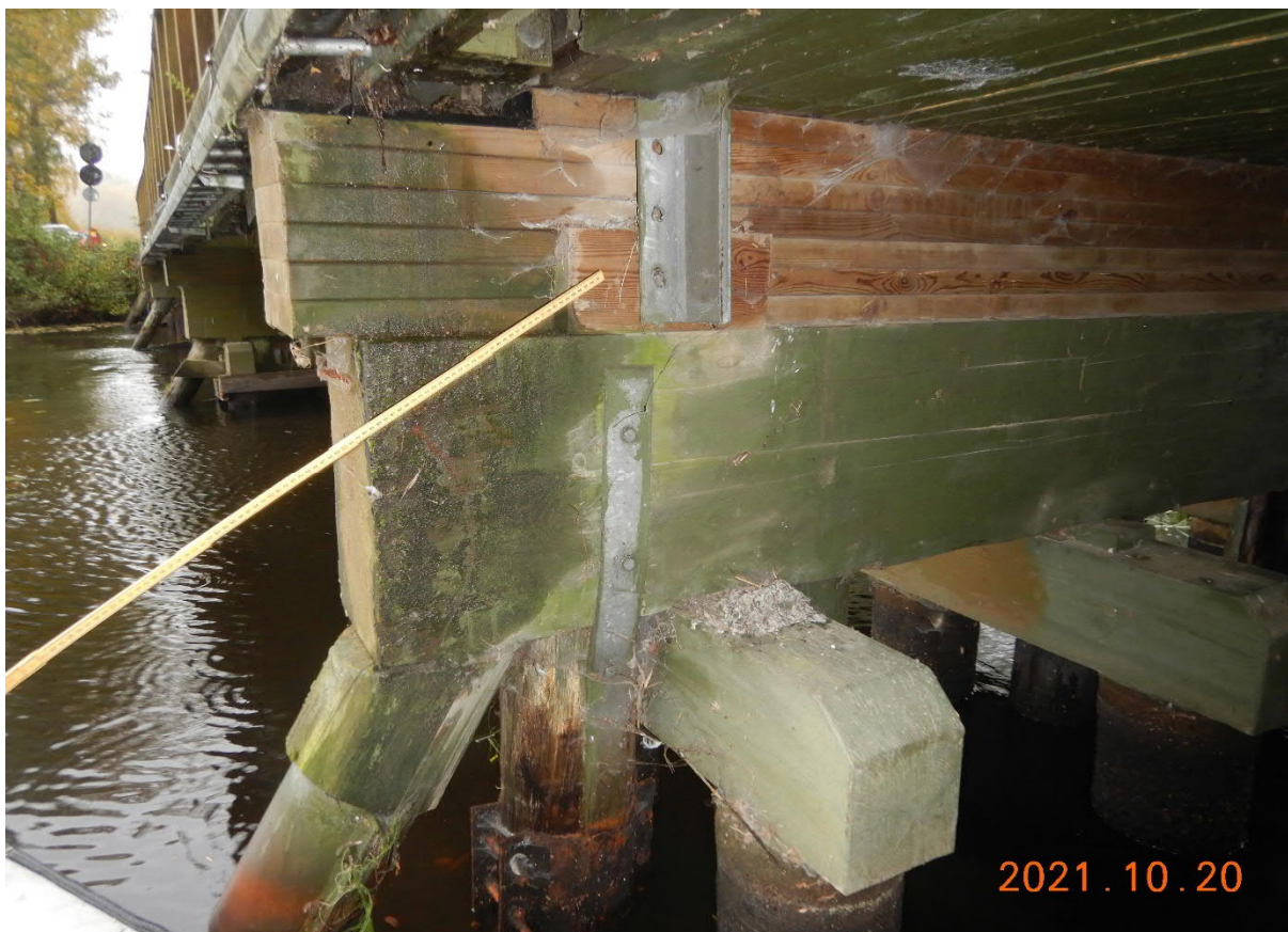
Foto nr 25, infästningsdetalj lös och saknar infästningar vid mellanstöd
