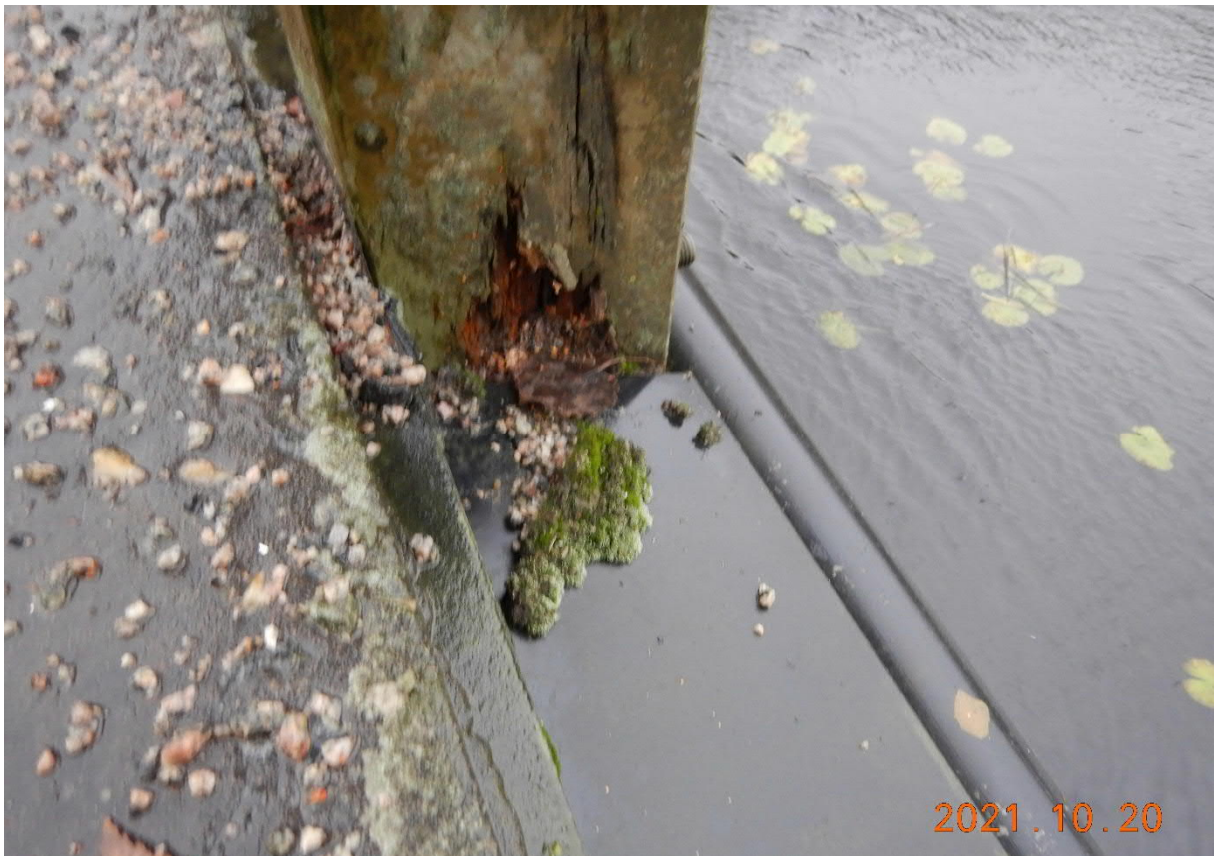
Foto nr 4, rötskador räcketståndare
