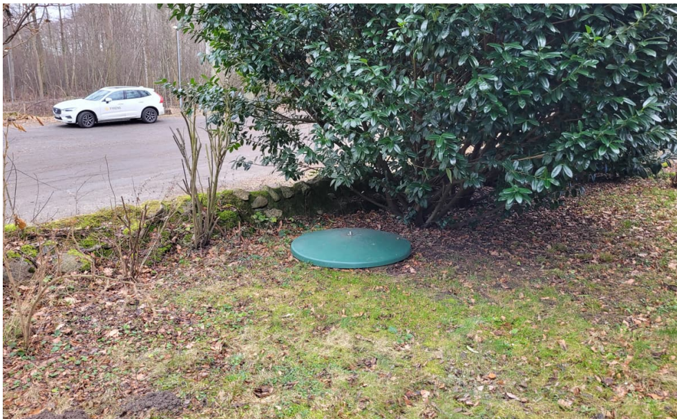
Figur 20. Enskild avloppsanläggning inom den norra delen av fastigheten. Anläggningen är numera tagen ur drift. Foto: Tyréns Sverige AB, 2023-12-19
